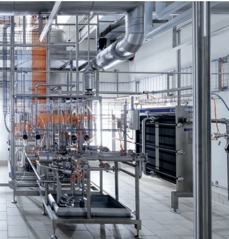
Blick auf die zahlreichen Rohre und Verkabelungen der Anlage.
